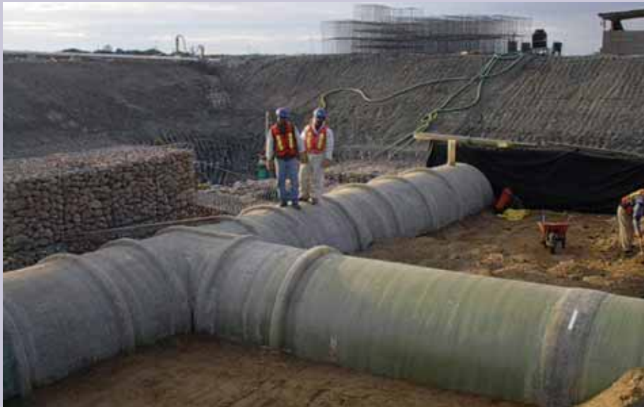
LNG re-gasification seawater intake pipe.
